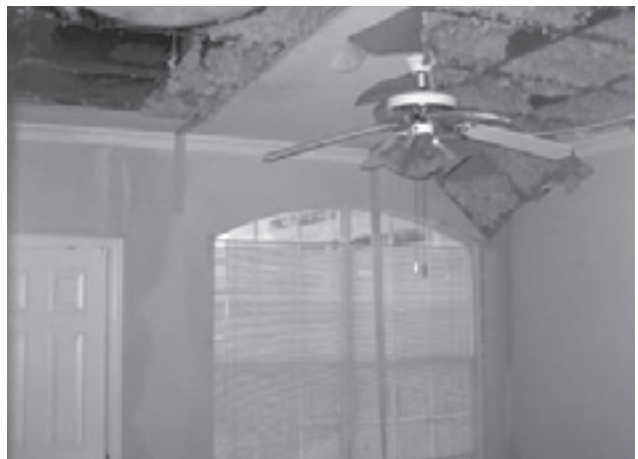
写真4) ハリケーン・アイクによる自宅崩壊の様子
